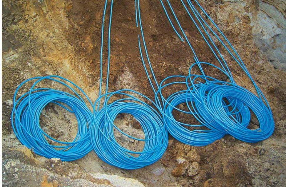
▲ Tuż za pompą ciepła rurki kolektora gruntowego „schodzą” pod ostrym kątem na głębokość roboczą (1,5-1,8 m)
